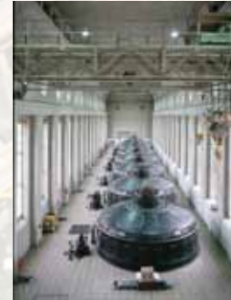
1919 in Oerlikon gebaute Generatoren im Kraftwerk Rheinsfelden.
