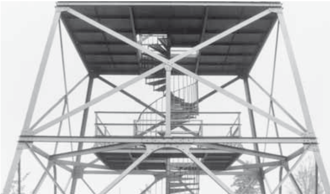
Aussichtsturm auf der Pfannenstil Hochwacht. Ausschnitt der Stahlfachwerkkonstruktion mit der Wendeltreppe. Zustand Mai 1996. KDP Fotoarchiv.
